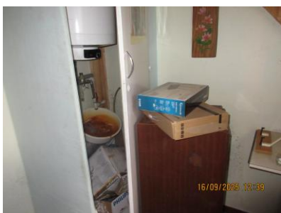
Chodba s bojlerem
