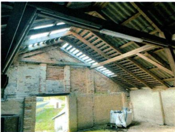
zatékání do krovu
