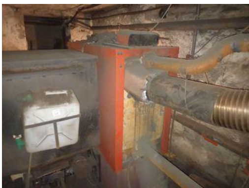
kotelná s kotlem
